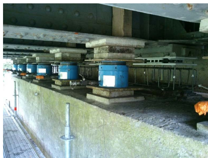
Vue des vérins bloqués sur écrou de sécurité, du ferrillage des bossages et des appareils d'appui
